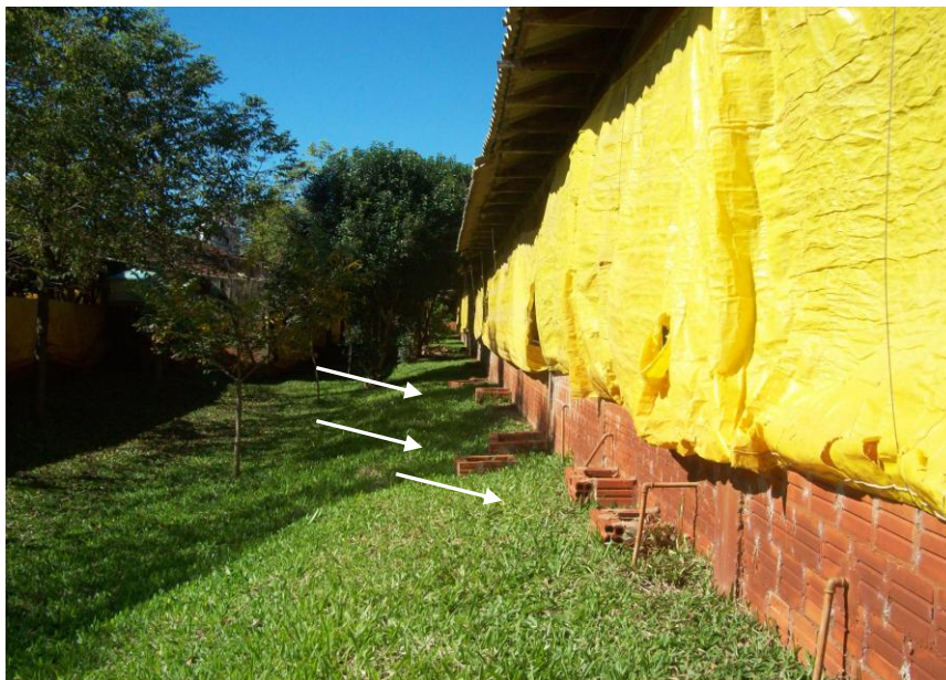
Figura 2: Tubulação coletora de dejetos
