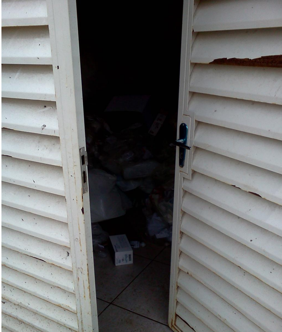
Figura 21: Porta da sala de resíduos da classe B no andar térreo. Fonte: Elaborado pelo autor, 2015.
