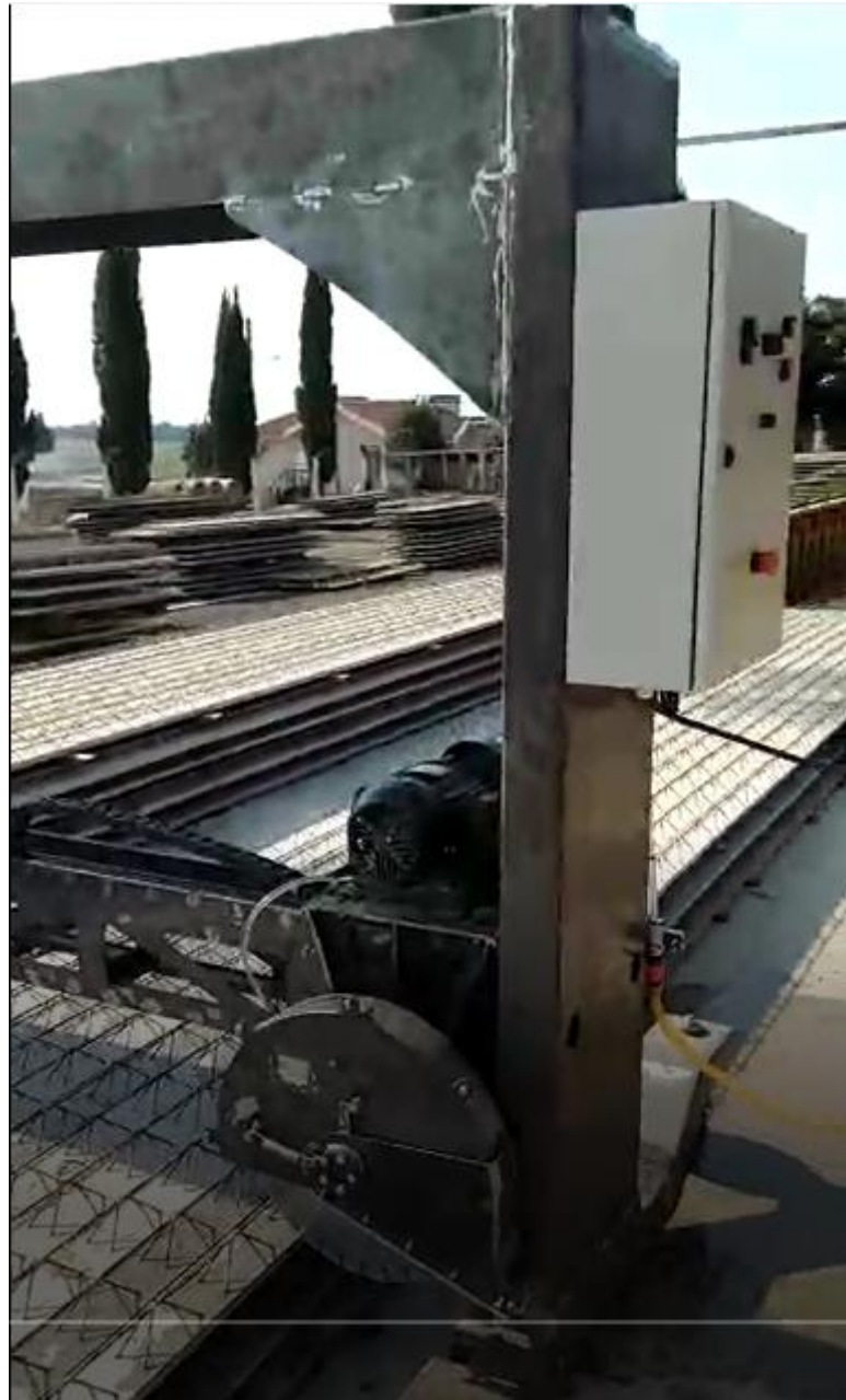
Figura 14 – Sistema de comando
