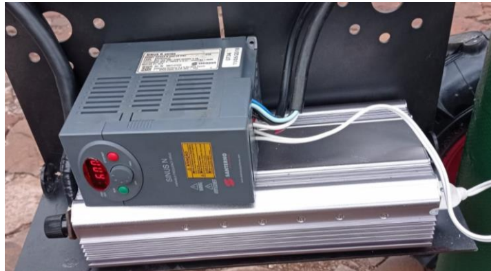
Figura 39 -Conversor DC/ AC e inversor
